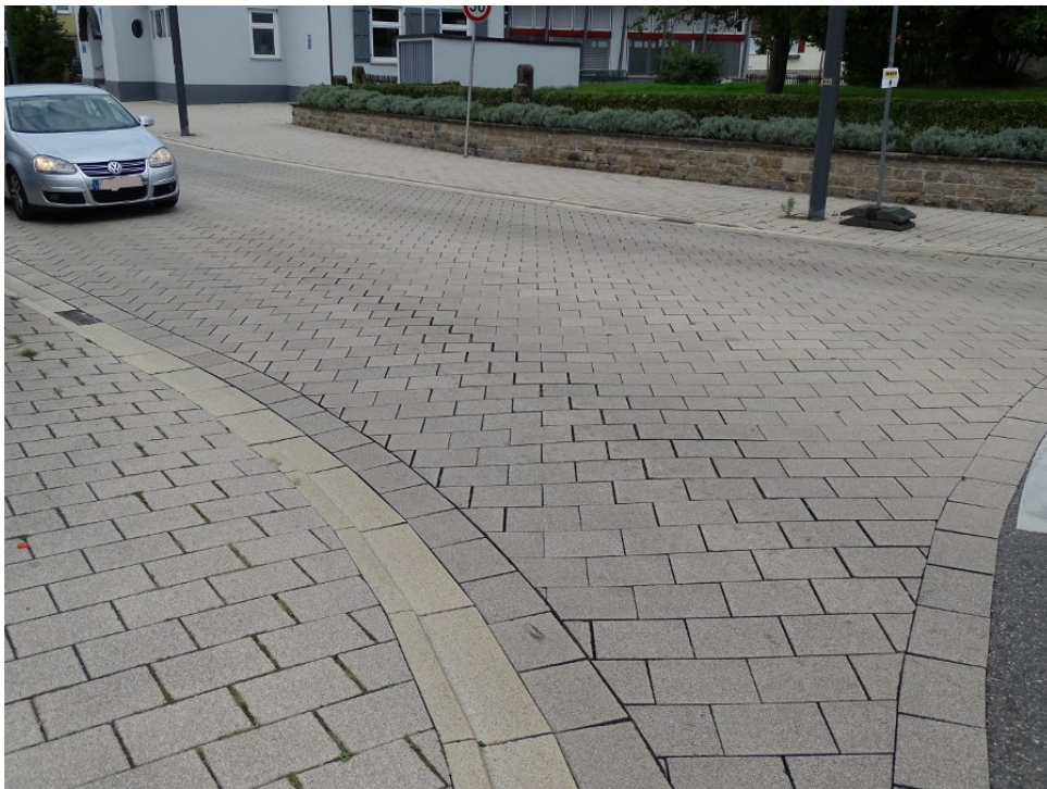
Abbildung 3.7 Obwohl die Strecke erst vor ein paar Jahren umgebaut wurde, zeigen sich in der Pflasterdecke bereits Setzungen. Vorne das etwa 2 bis 3 cm hohe Bord mit Entwässerung zwischen Gehweg und Fahrbahn. Auch wenn die Strecke angelehnt an Shared Space gestaltet wurde, so besitzt sie für die schwächeren Verkehrsteilnehmer trotzdem Gehbereiche als wichtige Schutzräume. Verkehrsrechtlich gibt es also auch hier eine Trennung nach Gehweg und Fahrbahn. Dies ist vor allem für mobilitätseingeschränkte, wie Blinde, wichtig. Bild: Swen Schneider 09-2019
