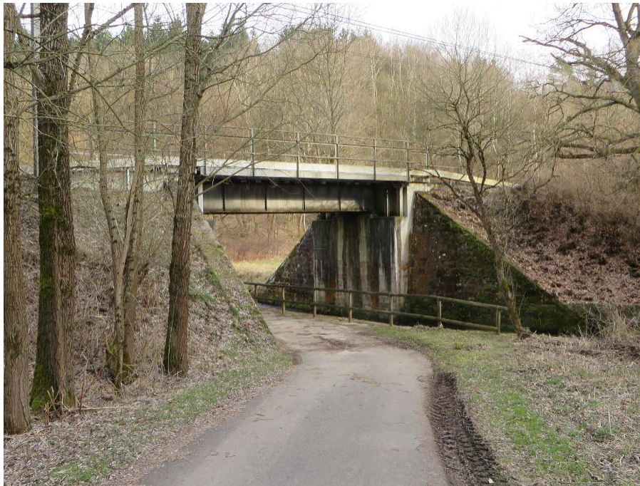
Abbildung 3.1 Losse und Herkules-Wartburg-Weg unterqueren die Brücke der Tram-Linie 8 Kassel – Hessisch Lichtenau: für den Radverkehr bestehen erhöhte Kollisions- und Sturzgefahr (HEL_18).
