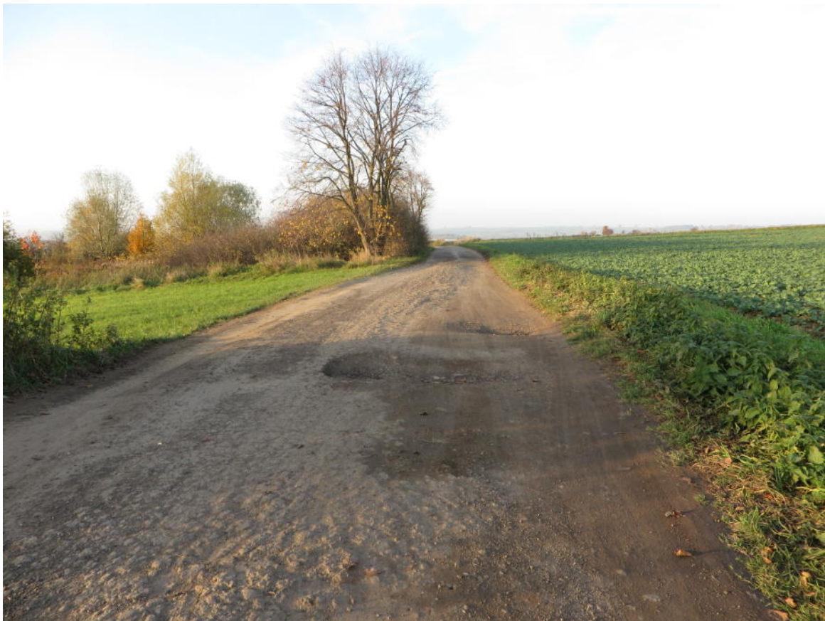
Abbildung 2.1 Verbindung Immenhausen - Espenau-Hohenkirchen: Gut zu erkennen die stark zerstörte Asphalttragschicht des Wirtschaftswegs. Auf dem rund 850 m langen Wegabschnitt besteht erhebliche Sturzgefahr. Laut Auskunft des Kreisradverkehrsbeauftragten ist hier eine Deckenverbesserung (Asphaltierung) durch die Gemeinde Immenhausen angedacht.
